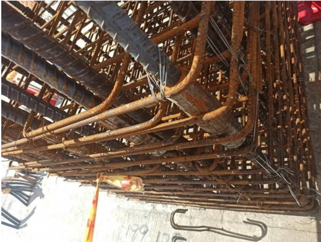
柱之一筆箍筋轉角處未鉤到柱主筋
