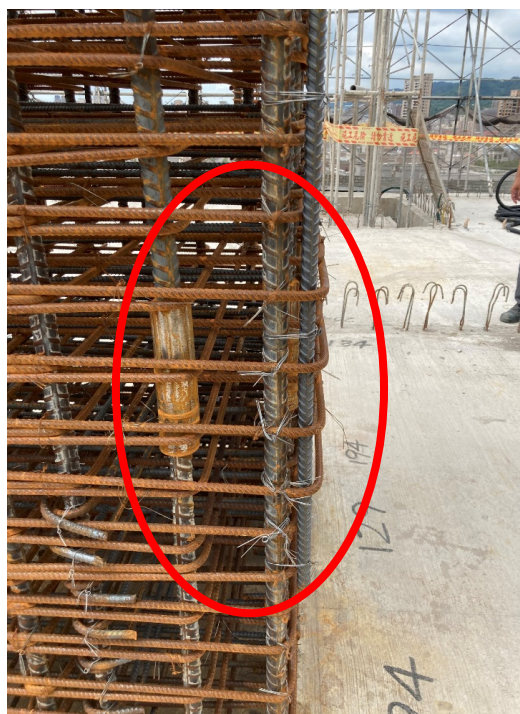
圖二 柱之一筆箍箍筋轉角處未鉤到柱主筋之補強案例
